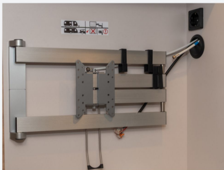
TV-Vorbereitung mit Steckdose und Kabelverlegung/-durchführung
