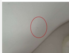
Bild 12 Durchstoßbeschädigung, Innenwand Alkoven beschädigt
